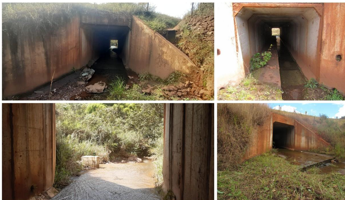
Figura 2 – Detalhes das passagens de fauna inferiores (PFI A1 e PFI A2) instaladas em um trecho da Alça Norte como estruturas de travessia de fauna.
