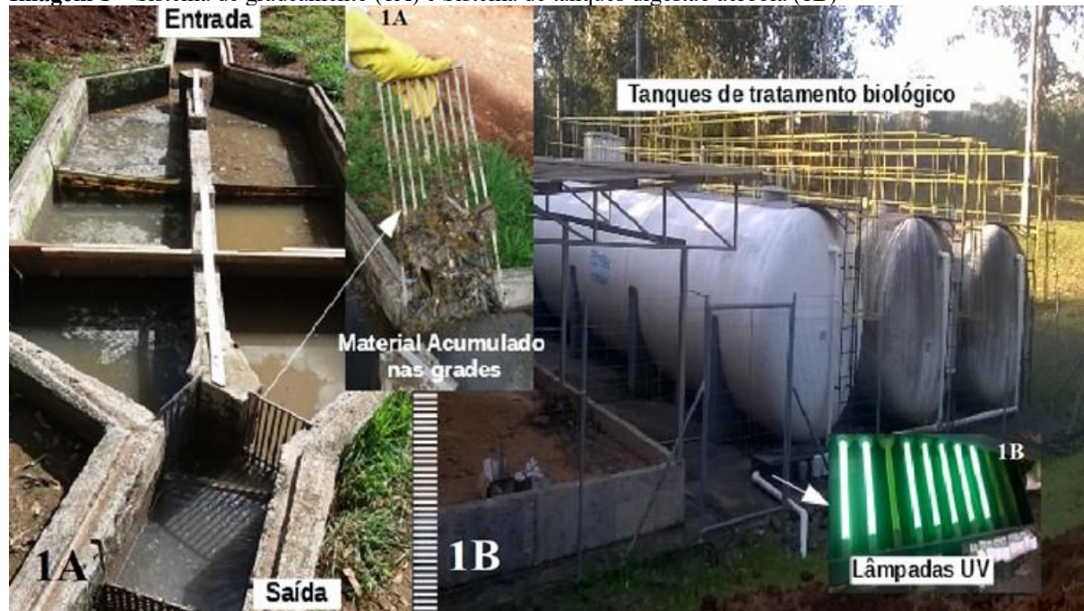
Imagem 1 – Sistema de gradeamento (1A) e Sistema de tanques digestão aeróbia (1B)
